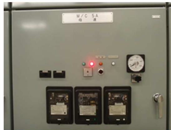
復電した所内共通M/Cの状況
