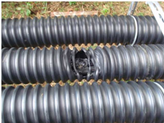
損傷したケーブルの状況
