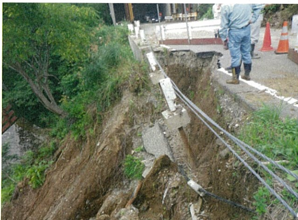
道路の路肩が崩壊し、JR線路の上に土砂が流出しました。
