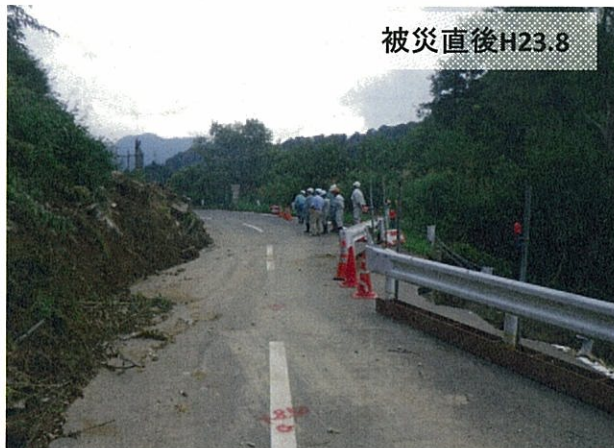
法面の土砂が崩壊し、道路がふさがれました
