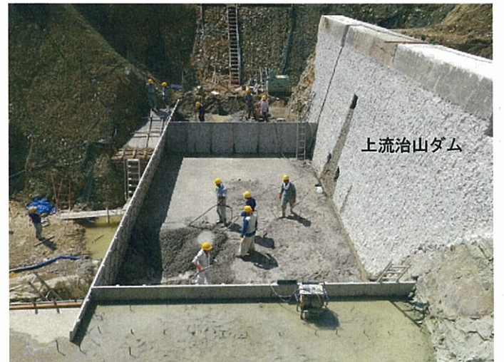
大型残存型枠を使用したコンクリート打設(平成24年8月31日撮影)
