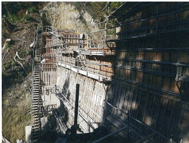
一般的な型枠足場
