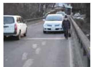
幅員が狭く通行支障の状況(霊山松川線・逢隈橋)
