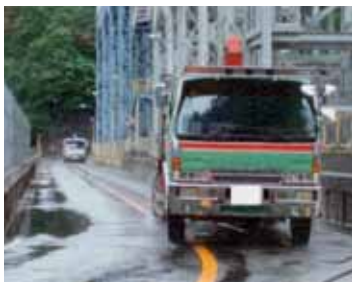
大型車すれ違い困難状況 (国道252号・本名橋)
