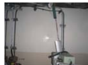
使用済燃料プールを支持する壁
