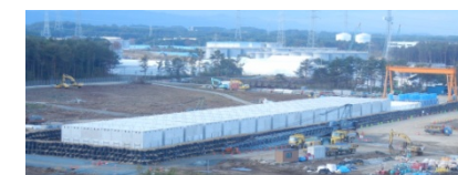
セシウム吸着塔一時保管施設（外観）
