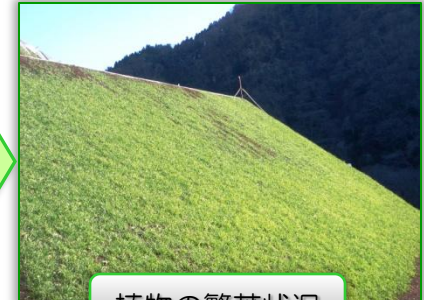
植物の繁茂状況
