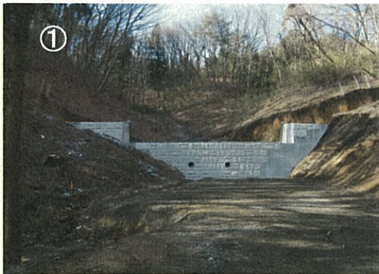
河川名：金山沢 事業名：交付金事業 場所：西白河郡泉崎村大字太田川地内 工事説明：土石流による土砂災害を防止するため、砂防えん堤工の施工を進めています。
