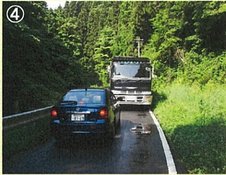
④ 路線名：勿来浅川線 事業名：地方特定道路整備事業 場所：東白川郡鯨川村大字赤坂東野地内 工事説明：県南地方(東白川郡)広域幹線道路であるとともに、スクールバスや緊急車両等の通行がある生活道路としても必要性の高い道路であり、2車線化による道路線形及び幅員狭小の改良を図り、安全で円滑な交通を促進します。
