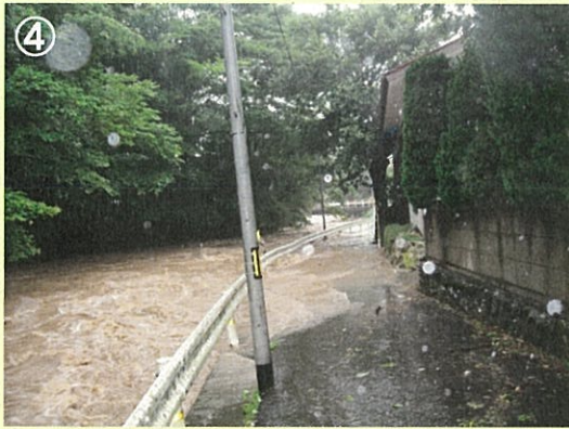
河川名：渡瀬川 事業名：河川海岸改良事業 場所：東白川郡鉸川村大字渡瀬地内 工事説明：村道や住宅の浸水被害を防止するため、河道拡幅や護岸工の施工を進めています。
