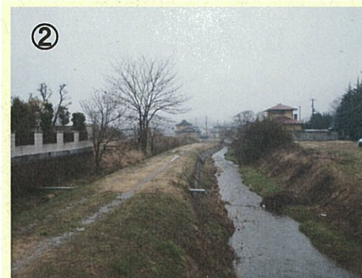
河川名：谷津田川 事業名：交付金事業 場所：西白河郡西郷村大字小田倉地内 工事説明：河道狭小による浸水被害を防止するため、河道拡幅や護岸工の施工を進めています。
