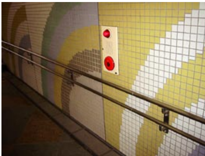
非常警報装置の一例
