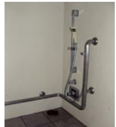
足腰の悪い方でも利用しやすいシャワー室の例(会津大学)
