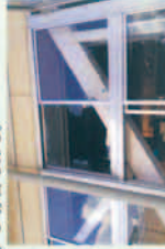
強化ガラスの破損
