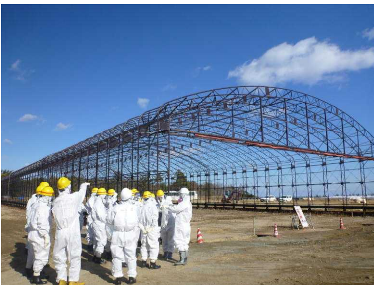
○安全対策部会現地調査 （覆土式一時保管施設） 第4槽設置予定地付近に 仮置きされている移動式全 面テント
