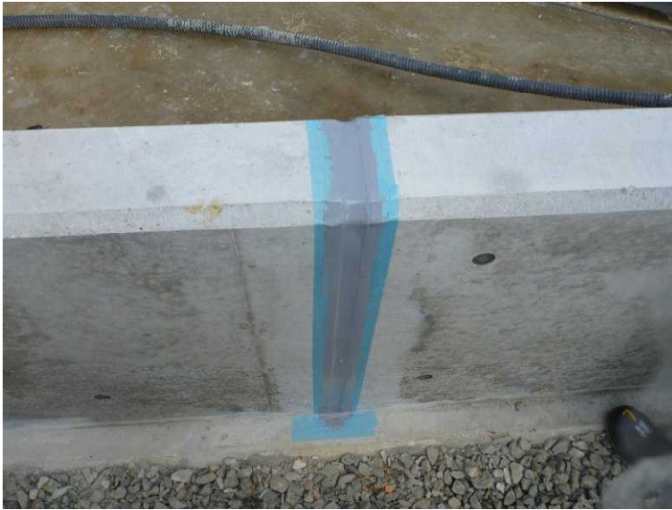
○現地確認 (G4タンクエリア) 基礎コンクリートのつなぎ目のシール施工
