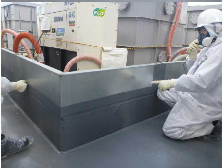
○現地確認 (G4タンクエリア) 鋼製の堰のつなぎ目の塗装の状況
