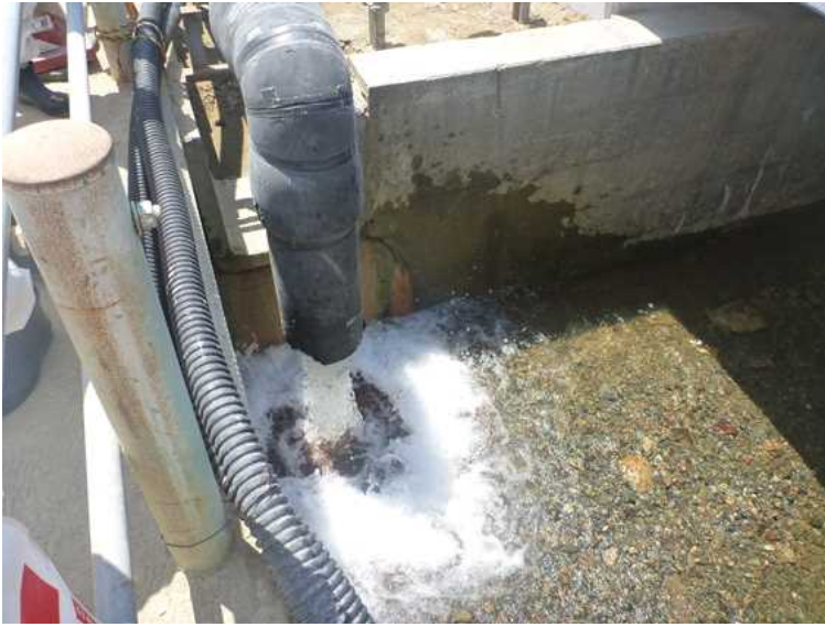
○地下水バイパス (放水状況確認)
