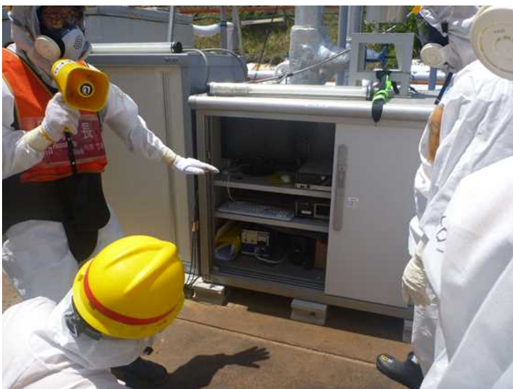
○凍土遮水壁実証試験 (トレンド計測用計算機)
