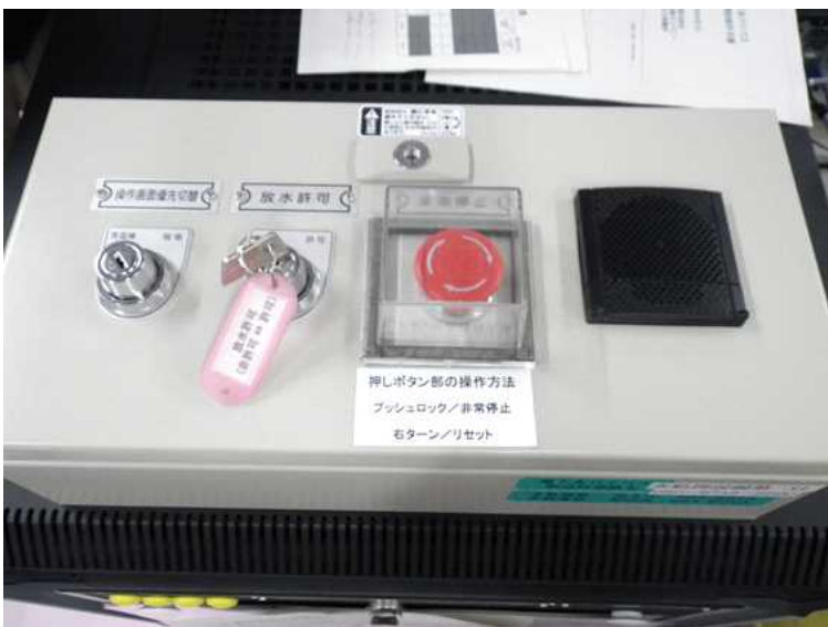
○地下水バイパス (免震重要棟放水許可スイ ッチ)
