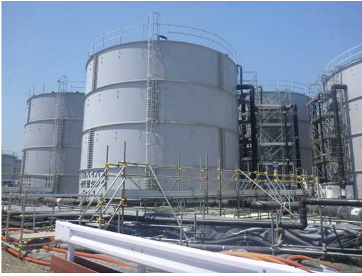
○地下水バイパス (一時貯留タンク)
