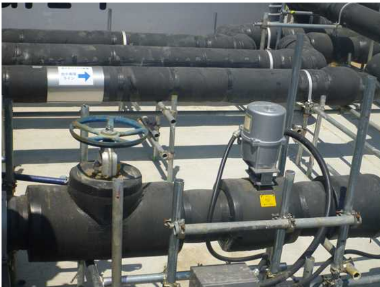
○地下水バイパス (右：放水ライン止め弁) (左：流量調整手動弁)
