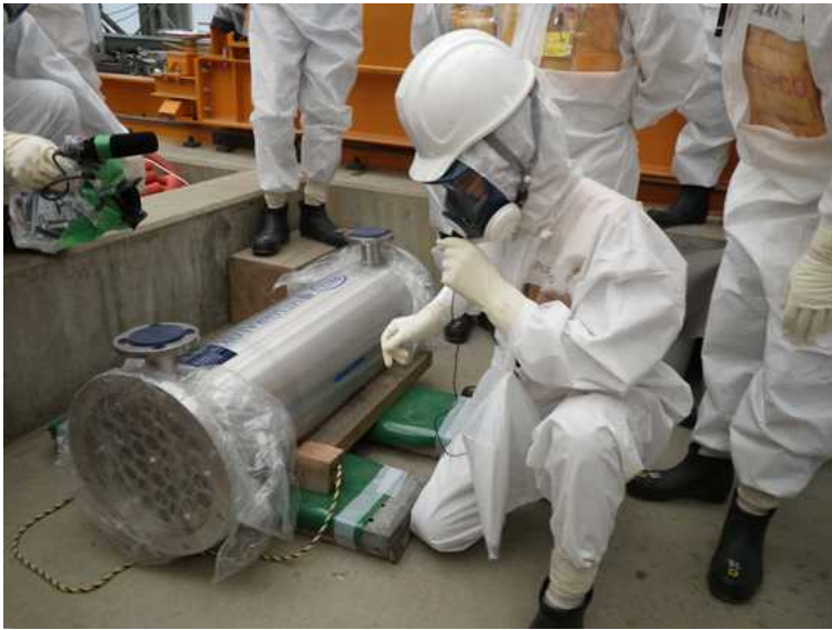
○多核種除去設備（ALPS） （クロスフローフィルタの 確認状況）
