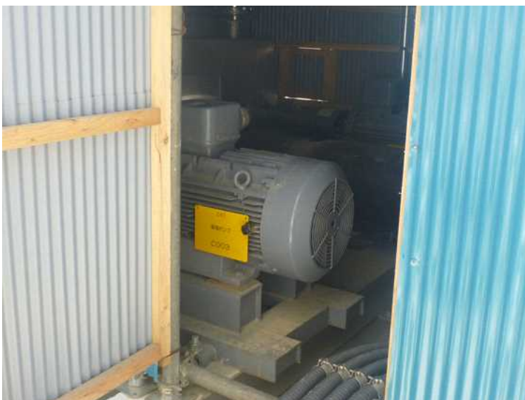
○地下水バイパス (手前：循環ポンプ) (奥側：放水ポンプ)
