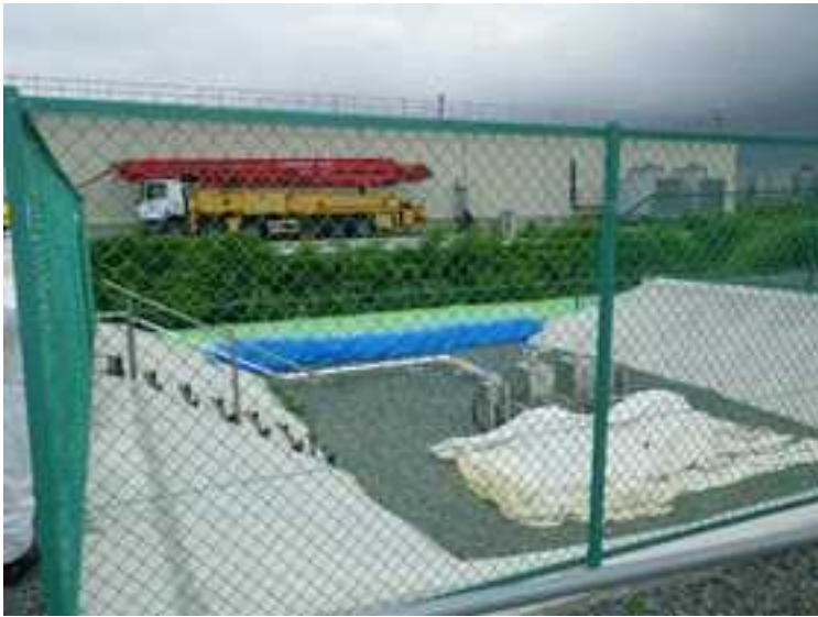
○排水路側溝放射線 モニタの状況
