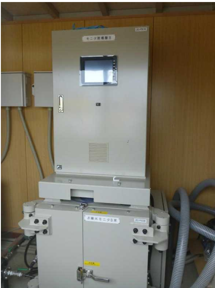
○排水路側溝放射線 モニタの分析装置及び 制御盤
