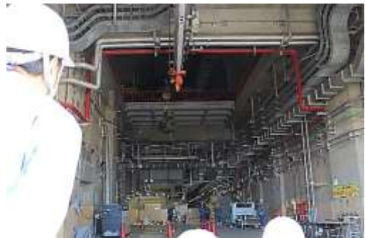
4号機タービン建屋(電動機取替訓練を確認している様子)
