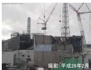
撮影：平成26年2月 ガレキ撤去後
