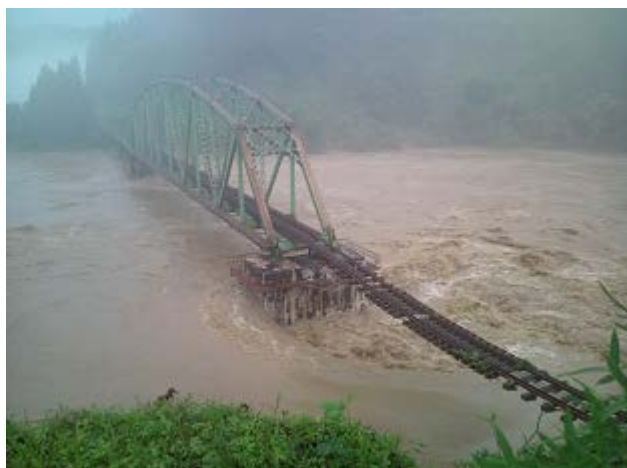
【写真1.1】 JR只見線 第5只見川橋梁流出
