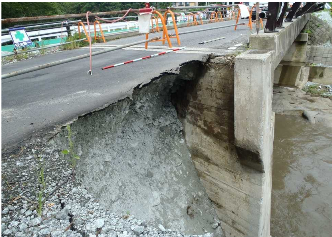
[5]主要地方道長沼喜久田線箕田橋の被災状況(須賀川市滝地内)
