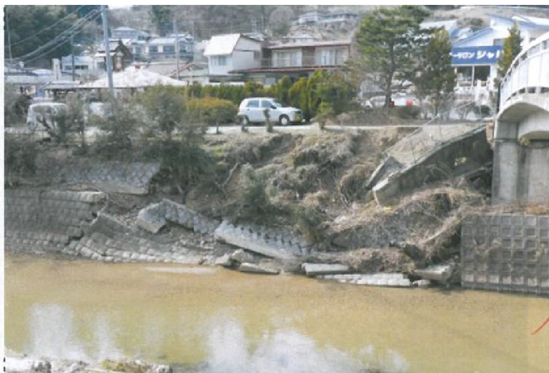
[7]桜川の護岸崩壊状況(田村郡三春町地内)
