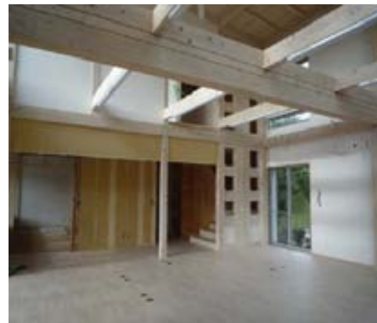
写真4 梁間方向7,200mmをとばすロングスパンの重ね梁と数少ない壁から水平耐力を生み出す高倍率耐力壁
