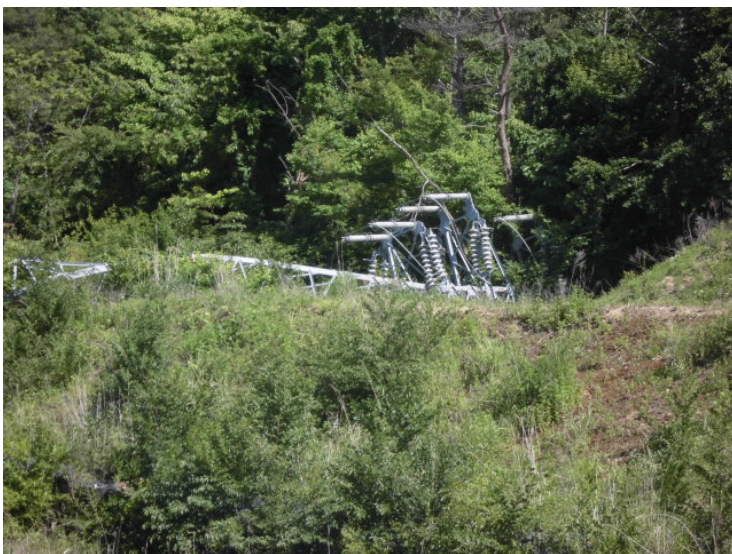
夜ノ森線鉄塔倒壊現場
