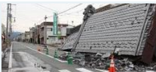
小高中心街液状化倒壊等
