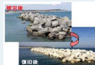
防波堤等の被災及び復旧状況
