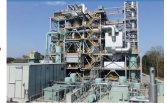
広野町仮設焼却炉
