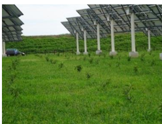
一時転用により太陽光発電を実施(いわき市)
