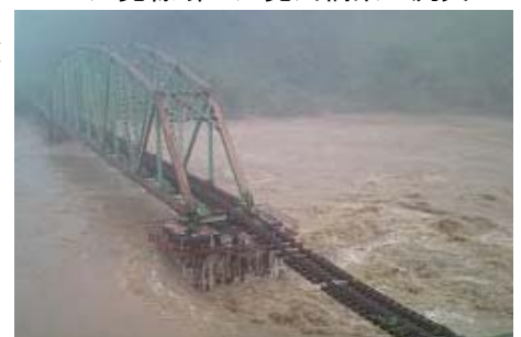
JR只見線 第5只見川橋梁の流失
