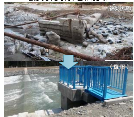
被災した取柵堰(只見町)
