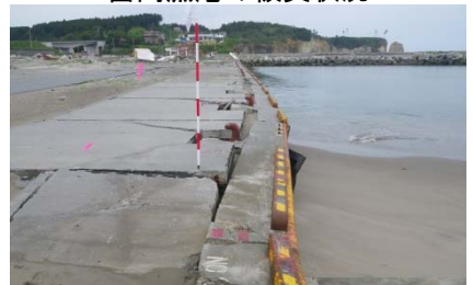
富岡漁港の被災状況
