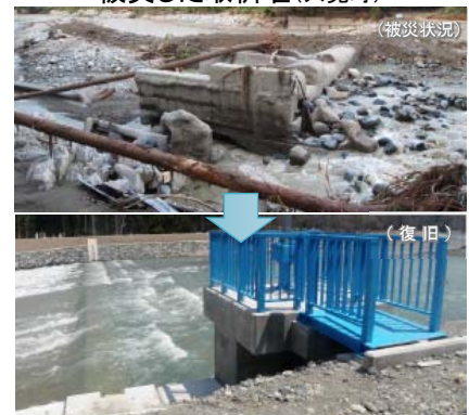
被災した取樹堰（只見町）
