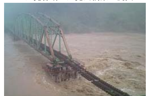
JR只見線 第5只見川橋梁の流失
