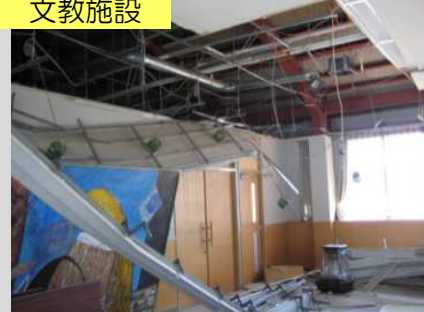
岩瀬農業高校の被害状況(3/15)
