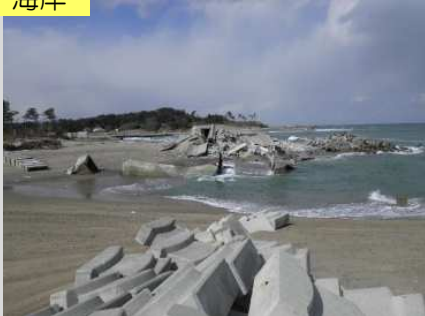
木崎海岸の被害状況(3/29)
