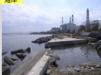
岩間・佐糠地区海岸の被害状況(5/26)
