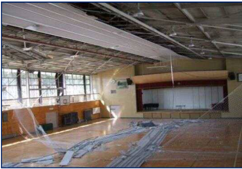
小野高校体育館の被害状況（4/15）
