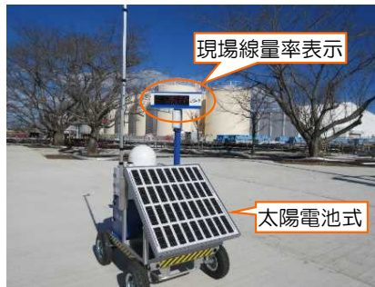
現場線量率モニタの設置状況
