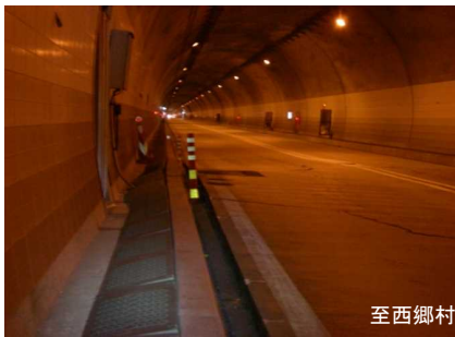
写真1 変状箇所(1工区)
