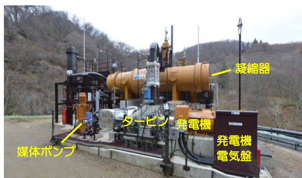
土湯温泉町16号源泉バイナリー発電所（福島市）
