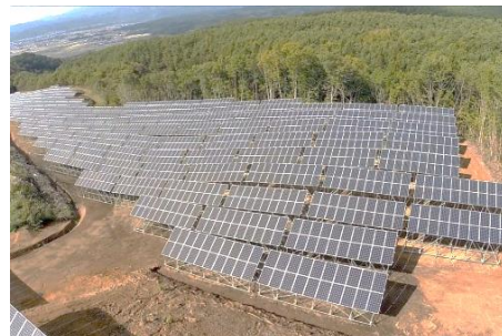
会津電力 雄国発電所 (1MW、H26.10稼働) 喜多方市
