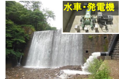
大野台浄水場・環境省実証事業 (71.4kW、H27.7稼動)相馬市
