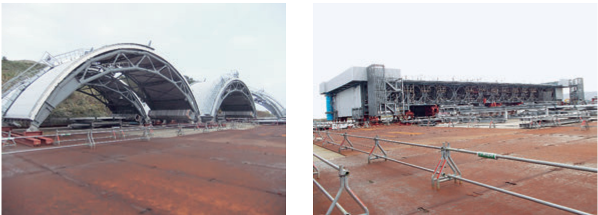
図 3号機燃料取り出し設備
