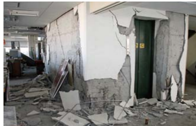
須賀川市 市役所庁舎2階の被災状況
