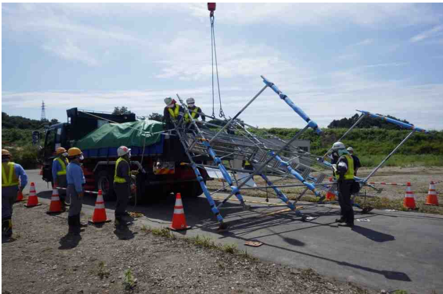
足場の転倒状況
