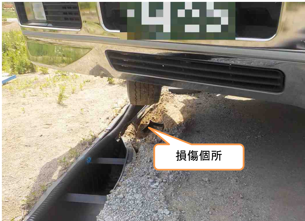
U字溝の損傷状況
