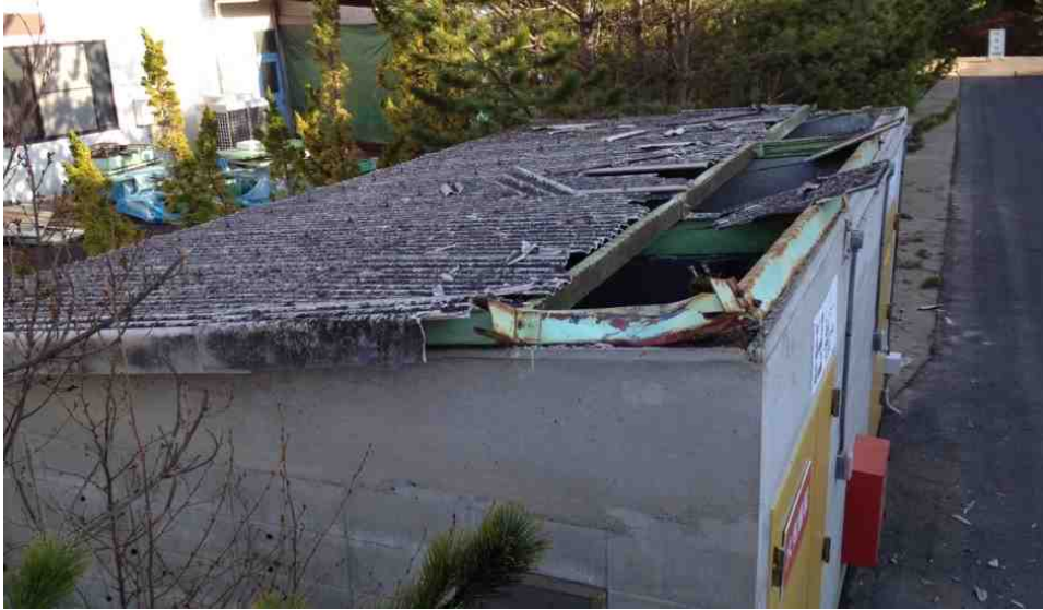
損傷後の倉庫の状況
