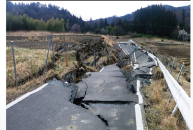
③ 地震による農道崩壊被害 (小川町高谷地区)
