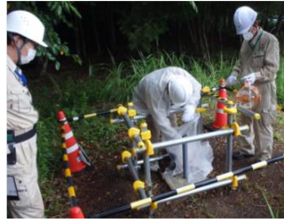
双葉工区地下水観測井
