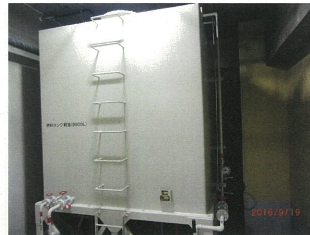
発電機用燃料タンク
