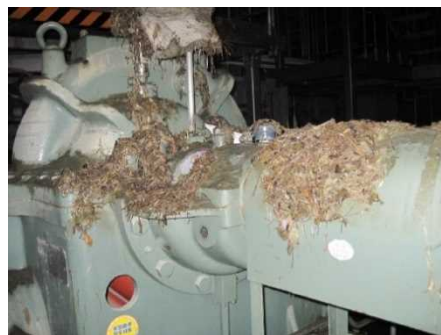
津波によるポンプの被水状況
