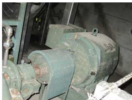
津波によるモータの被水状況
