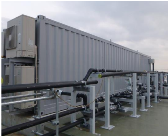
【地下水ドレン前処理装置の設置状況（4m盤）】
