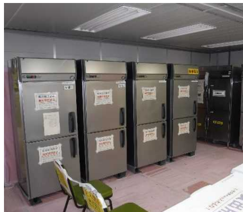
保冷剤冷凍庫の配備
