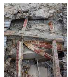
瓦礫の状況 (原子炉ウェル近傍)
