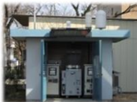
モニタリングポスト内部 (大熊町大野局)
