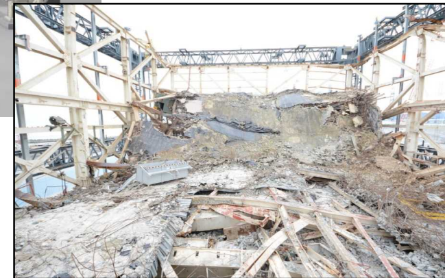
崩落屋根状況
