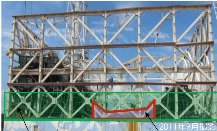
防風シート 原子炉建屋東側写真 ウェル近傍の空間 2011年9月撮影
