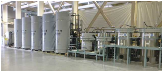
サブドレン他浄化設備 (B系)
