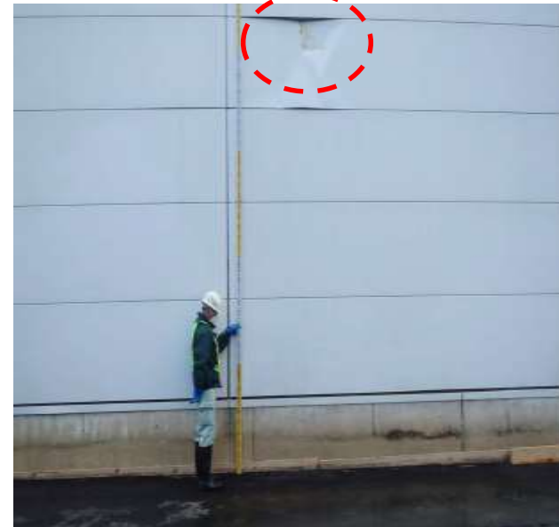
損傷した建屋
