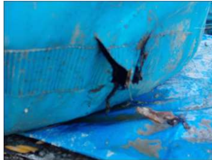
実際に切られた箇所
