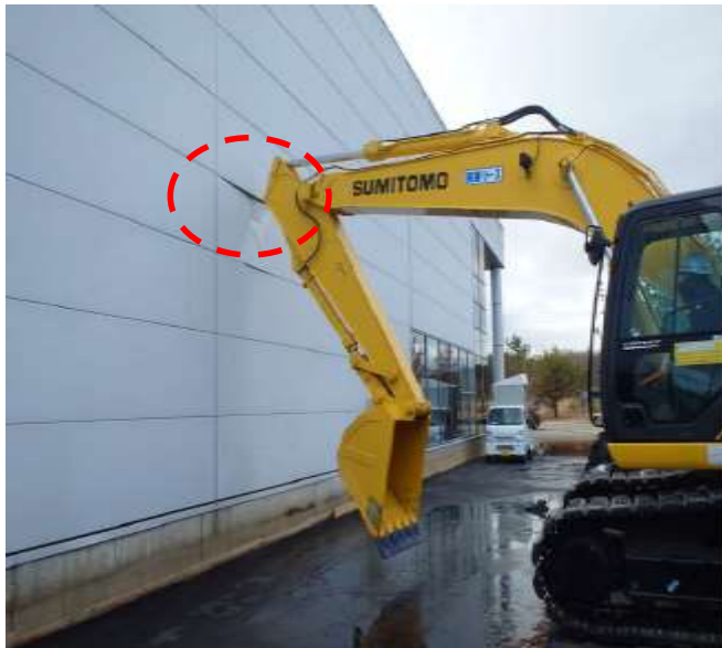
事故の現場状況
