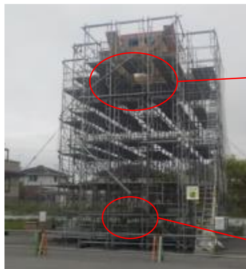
モックアップ設備
