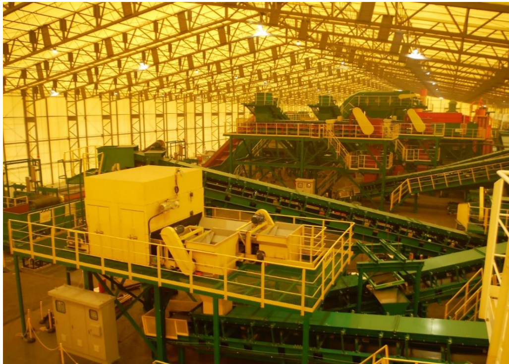
受入・分別施設(受入・分別棟内部)
