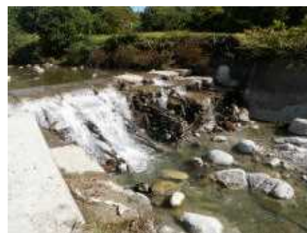
台風で被災した頭首工
