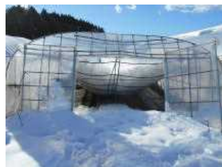
降雪で倒壊したパイプハウス
