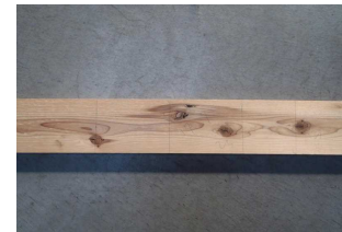
写真-1 穿孔性害虫の被害状況
