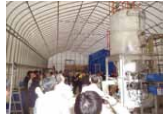
メタン発酵施設
