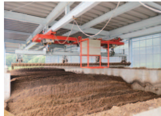
堆肥クレーン
