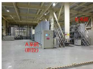
浄化設備の2系列化
